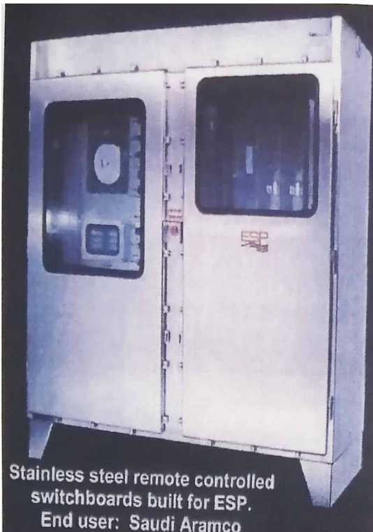
شکل ۲-۶ نمونه ای تابلوهای کنترل
